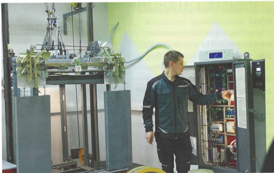
Новоселов Александр Сергеевич — начальник участка электронных систем управления и защиты лифта ООО СП «Тагиллифт-НТ» — объясняет устройство и принцип работы электронной станции лифта
