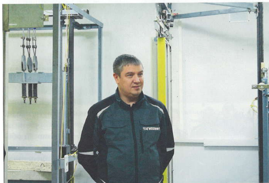
Пушанин Игорь Владимирович — начальник производственного участка ООО СП «Тагиллифт-НТ» — объясняет взаимодействие электронных и механических узлов лифта
